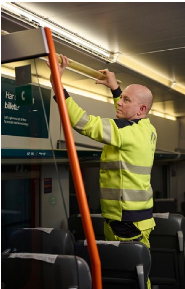
Hans Ingar Fossen, kvalitetskontrollør i Norske tog, tar ut et gammelt lysstoffrør som inneholder kvikksølv. De skal byttes med nye LED-lys.
